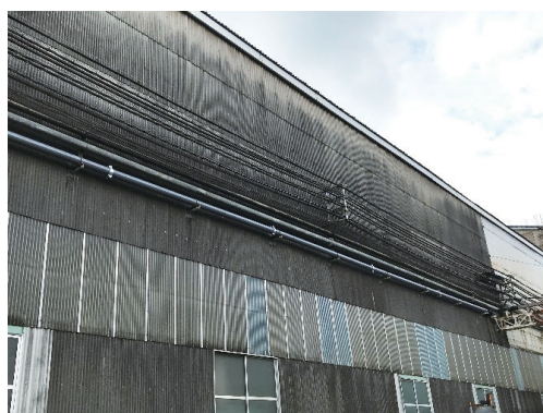
図5 工場内配管の例
