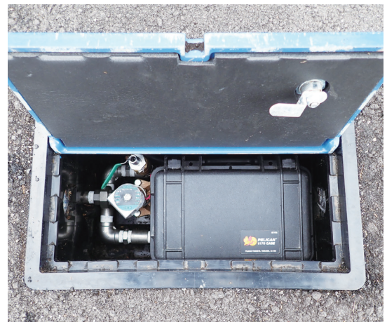
図2 量水器ボックス内への設置例
