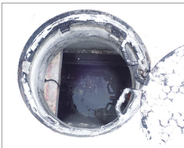
図 12 地点 A 地下水滞留による装置の水没状況
