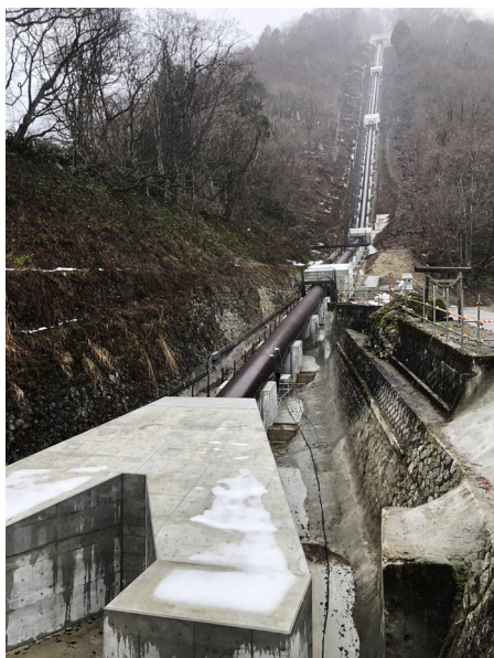
図3 二股発電所水圧鉄管
