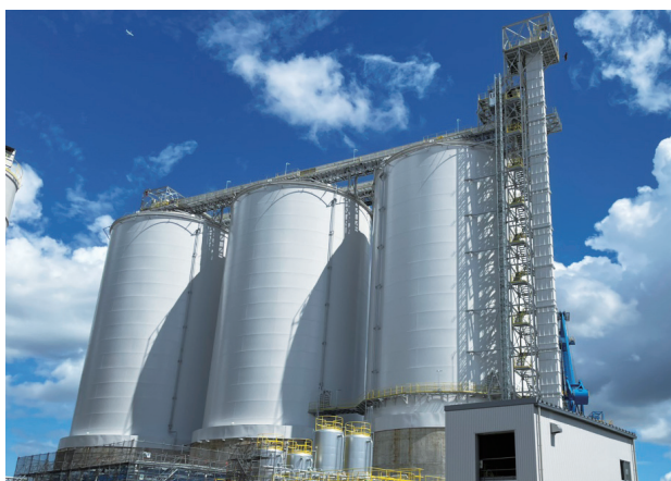
図1 搬送設備完成外観
