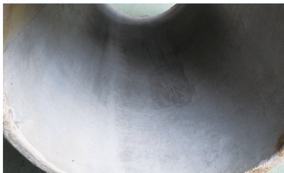
図1 38年間硫酸腐食環境下で通水試験を実施したエポキシ樹脂粉体塗装管の内面
