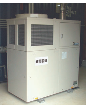
コージェネ発電装置。バイオガスをここで熱と電気として回収し施設内で利用します。
