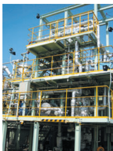
木質系バイオマスのガス化試験装置外観。
