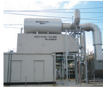
コージェネレーションシステム
