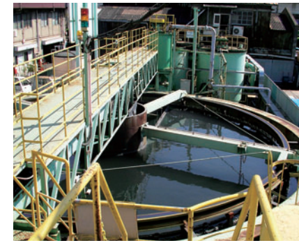
シクナー（凝集沈降槽）
