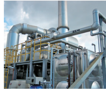
コージェネレーションシステム
