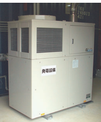
コージェネ発電装置。バイオガスをここで熱と電気として回収し施設内で利用します。
