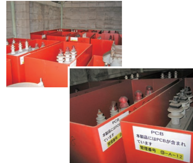
住吉工場では専用の倉庫に入れるだけでなく、さらに鋼鉄製ボックスの中に入れ、認識番号を付け徹底管理を行っています。
