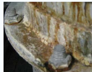
SS400製FG・一般錆止め仕様の臭突管の腐食例
