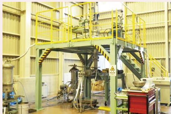
薄膜蒸発機+異速型SCプロセッサの脱溶剤システム
